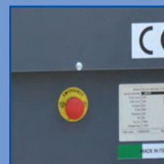
Pulsante emergenza permette lo spegnimento immediato del gruppo elettrogeno
