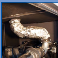
Tubi scarico coibentati per una maggiore protezione e sicurezza
